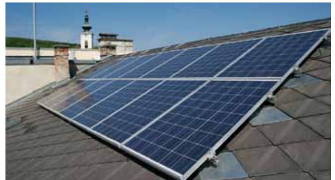
Die am 6. Mai 2011 übergebene Fotovoltaikanlage auf dem Dach der Ober St. Veiter Volksschule.
